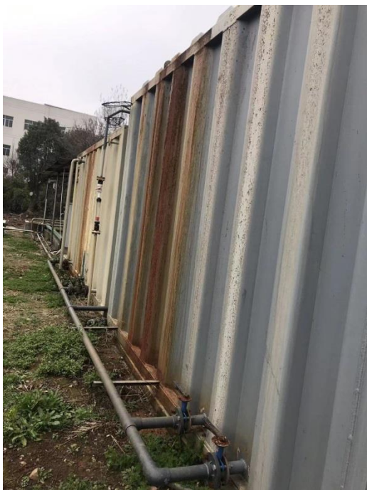
新建的污水处理站
